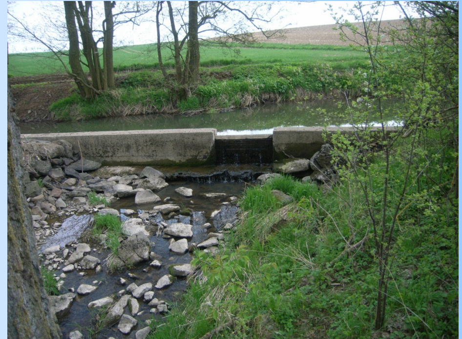
Wehr an der Antreff zum Zeitpunkt der Geländebegehung unzureichender Abfluss über die Ausleitungsstrecke
